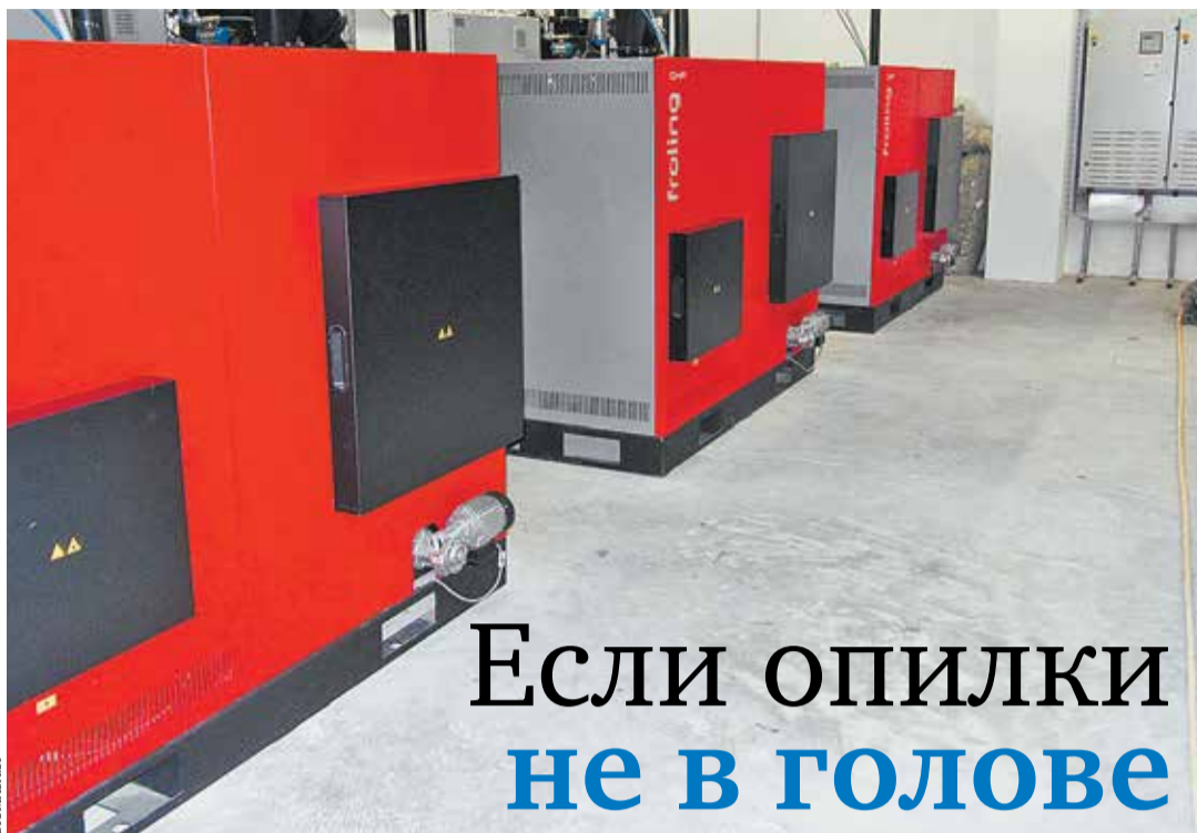
Газогенераторные установки CHP50, объединенные в каскадную систему
