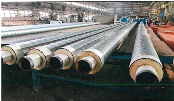
Фото 3: Общий вид труб повторного применения в изоляции
